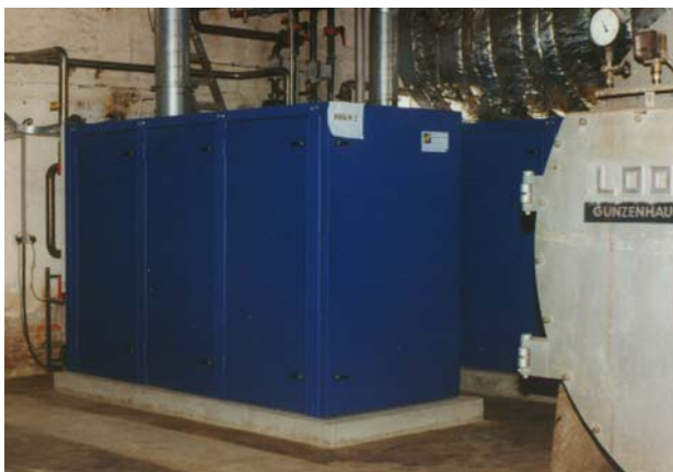
Bild 4: BHKW Anlage Altheim
