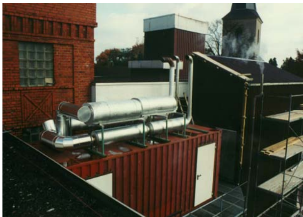
Bild 2: BHKW Anlage Brennerei Spradau
